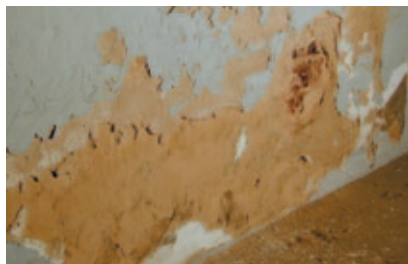
Innen deutlich sichtbar: Feuchte und Schimmelbildung an nahezu allen Wänden.
