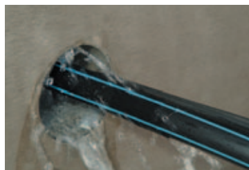
Wassereintritt an einer ...
